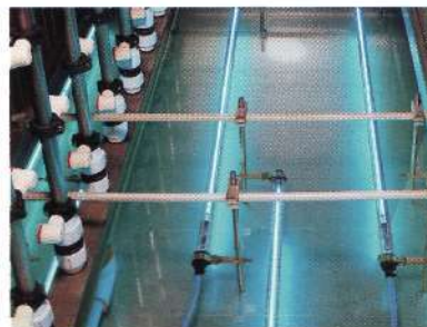
Luftbefeuchtung in einer Klimaanlage. BlueLight UV-Tauchlampen halten das Wasser keimfrei.
